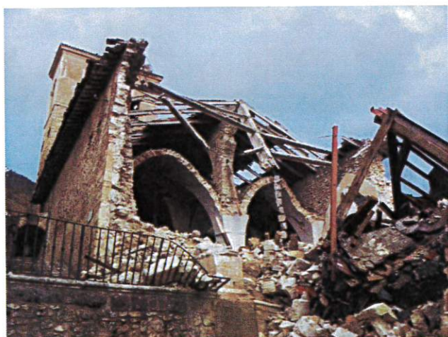
Figura 23 Chiesa di S. Andrea a Campi di Norcia, con copertura a travi Varese e tavellonato, poggiati su trave di colmo in calcestruzzo e cordolo cementizio perimetrale
