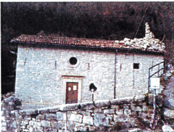
Figura 17 Chiesa di S. Pietro a Vallinfante (MC). La presenza dei tiranti sugli archi interni ha evitato il danneggiamento delle pareti laterali della navata.
