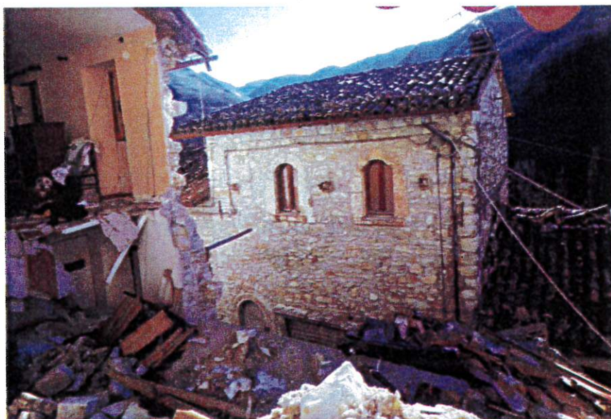
Figura 8 Edificio a muratura a vista con ristilatura dei giunti e danni limitati in contesto di crolli diffusi. Castelsantangelo sul Nera (MC)
